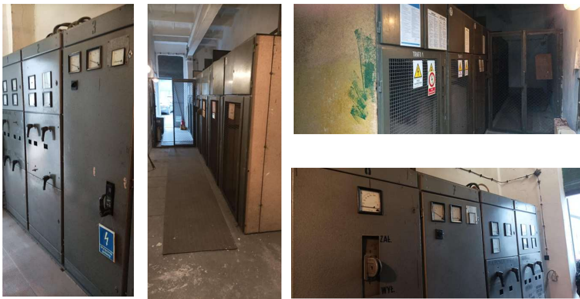
Widok stacji transformatorowej istniejącej – wewnątrz (od lewej: sekcja I Nn, korytarz obsługi i pola SN, korytarz obsługi i pola SN, sekcja I nN)
